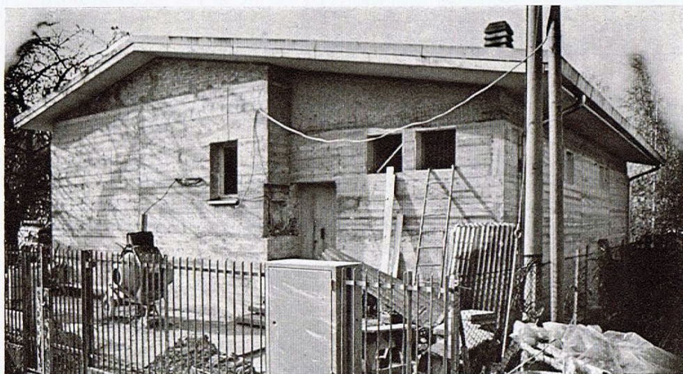
Tarcento: questa che appare nella foto è l'unica centrale sociale, di 63 coinvolte dall'evento sismico, che abbia richiesto un intervento edile di tipo strutturale. E' stata realizzata una parete esterna in calcestruzzo fortemente armato, saldamente ancorata alla vecchia muratura lesionata, ed in grado di resistere a sollecitazioni sismiche eccezionali.
